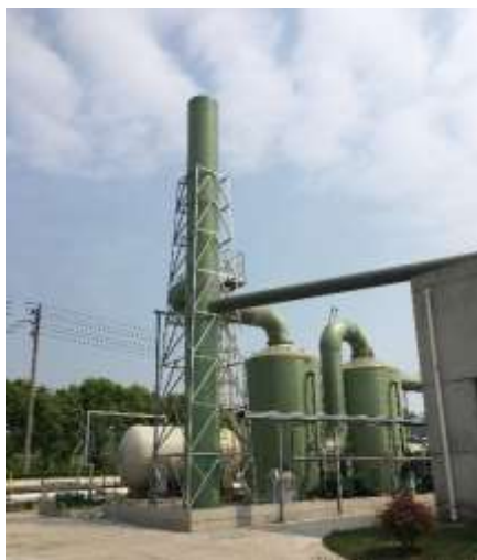
酸喷淋+碱喷淋吸收装置
