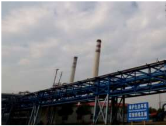
吡啶 1、2 号焚烧炉
