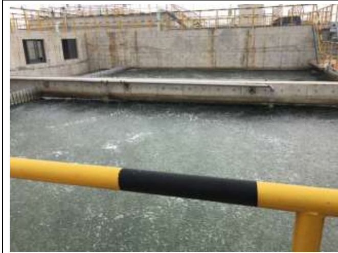
末端曝气生物滤池
