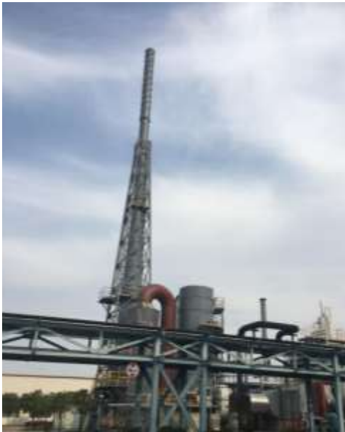
吡啶 3 号焚烧炉
