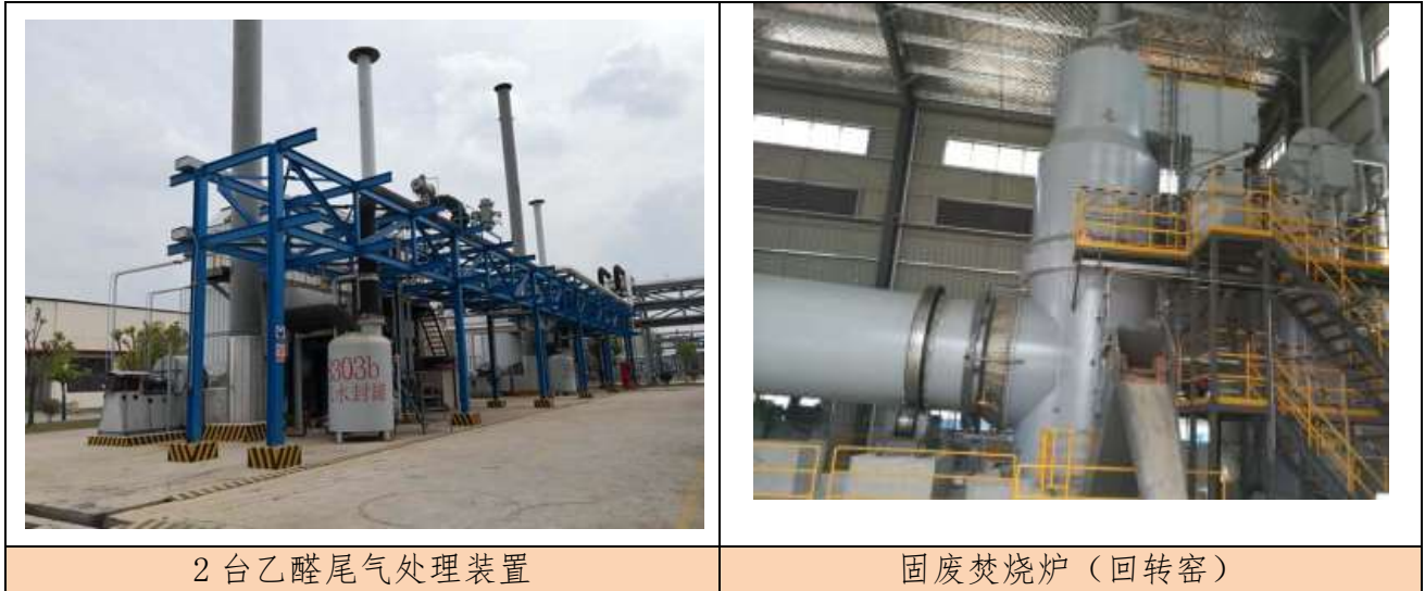
图 1.3-5 焚烧处理设施
